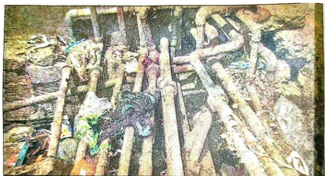
चौखंडी इलाके में नाले में पीएचडी की जर्जर पाइप पाइपों से होती है पानी की सफाई।
